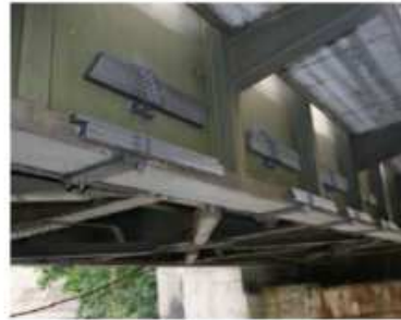
Absorbeur sur platelage
