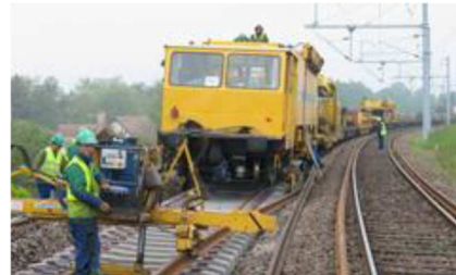
Longs rails soudés sur traverses béton
